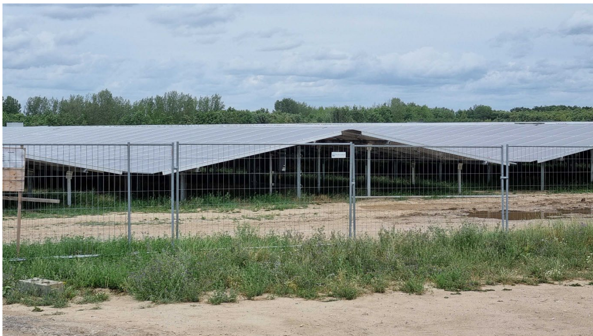
Abb. 8: Ost-West-Modulflächen des derzeit größten in Bau befindlichen Energieparks Witznitz auf rekultivierten Braunkohleflächen (Foto: D. Günnewig, Juli 2023)
